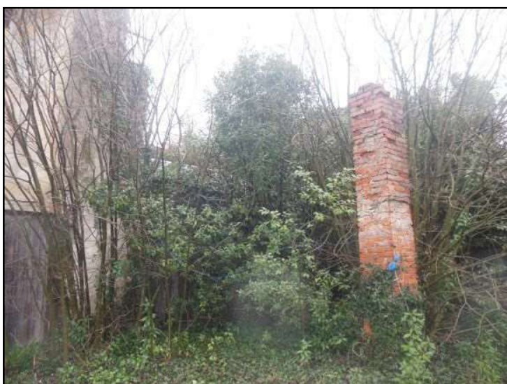
Porzione crollata del fabbricato principale
