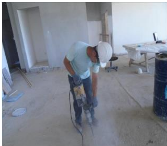
Uso di demolitore senza aspirazione della polvere
